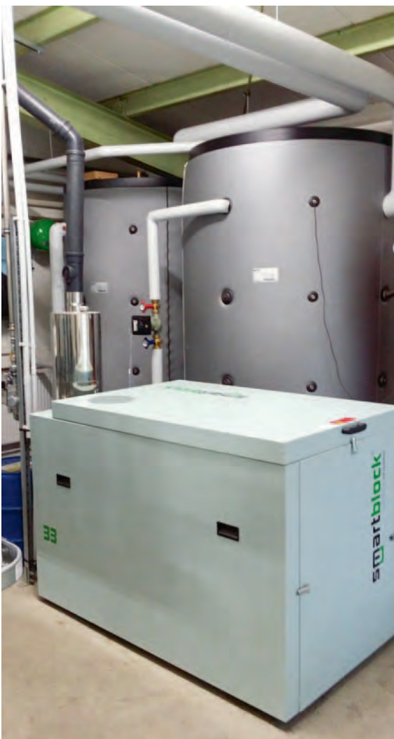
Perfekt dimensionierte 33 kW BHKW-Anlage in einem Duisburger Autohaus
