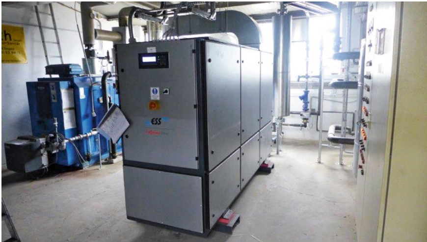
Rentabilität und Amortisationszeiten für Blockheizkraftwerke (Foto) und PV-Anlagen in Autohäusern werden durch die neue EEG-Umlage nur unwesentlich schlechter
